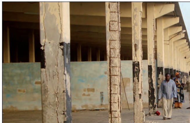
Poteaux érodés par le sel et les actions anthropiques
