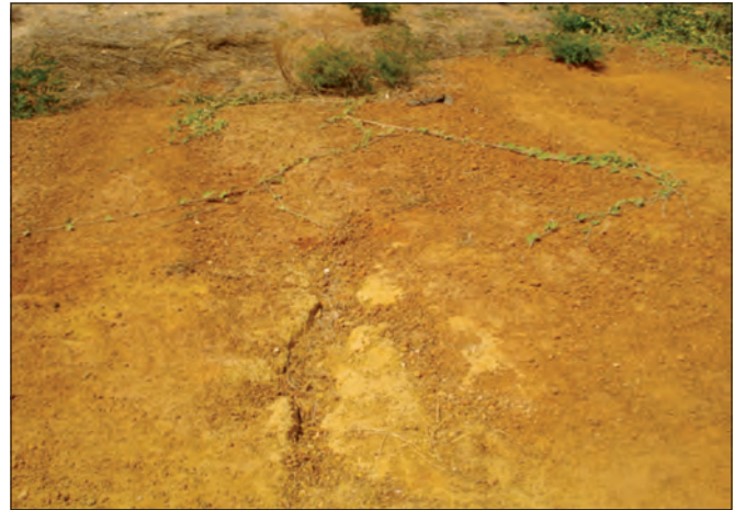
Fissures et début d'érosion sur le talus aval d'une digue en terre
