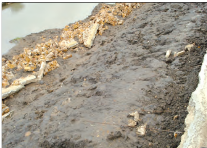
Eboulement du remblai et de la maçonnerie de moellons
