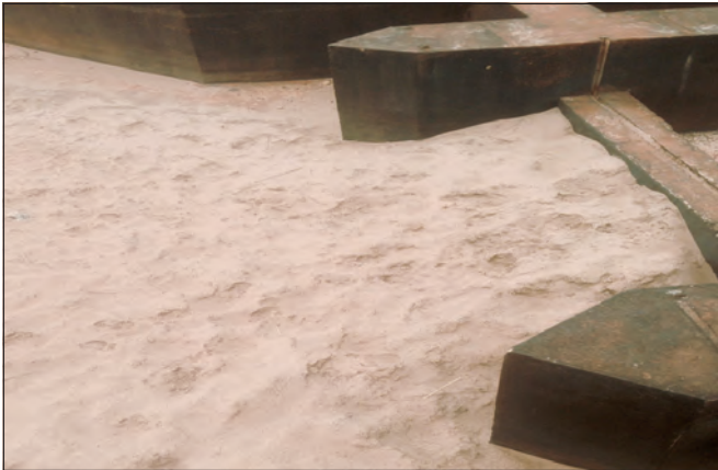
Ensablement du deversoir
