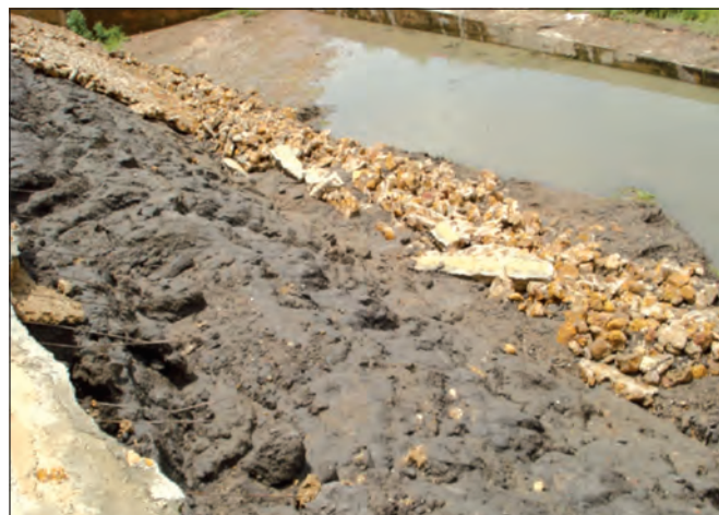
Eboulement de la partie aval d'une digue
