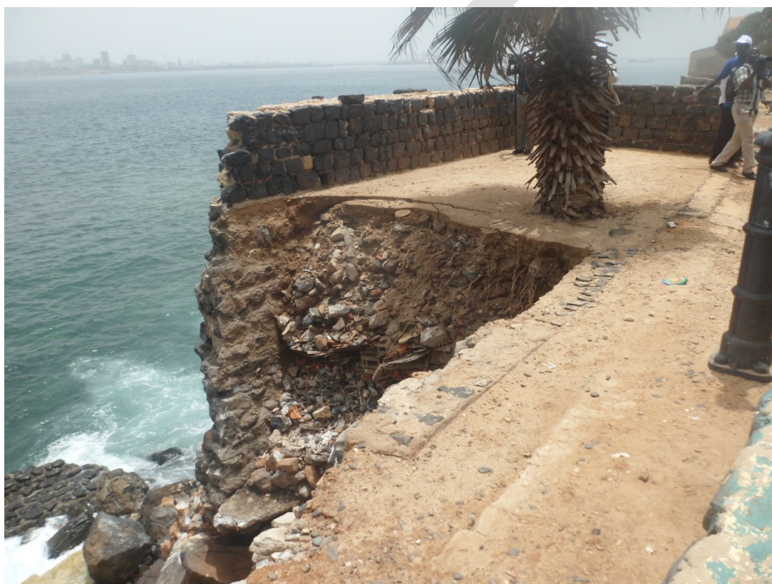
Affaissement du mur de protection sur l'île de Gorée au Sénégal
