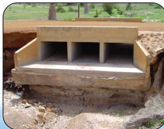
Menace sur les infrastructures
