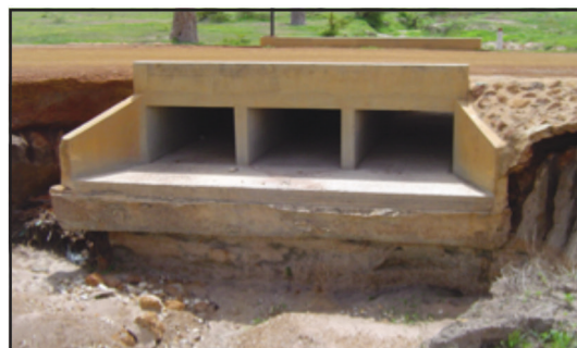
Photo 4 : Menace sur les infrastructures
